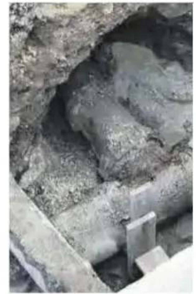
Imagen de una vieja tubería.
